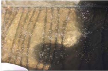
Fotografía 1. Tuberías distribuidoras de aire
