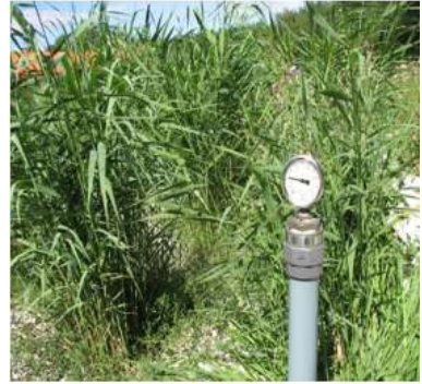
Fotografía 2. Dispositivo de medición de presión
