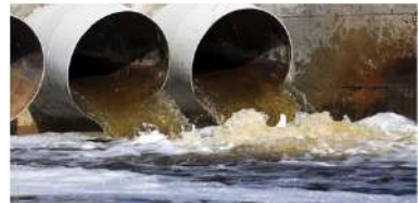
Figura 2. Aguas residuales [Fotografía], por Tecnología Del Agua, I. M. (s. f.) (HYPERLINK " https://www.gob.mx/imta/articulos/La-actualizacion-de-la-norma-sobre-descargas-de-aguas-residuales?idiom=es " https://www.gob.mx/imta/articulos/La-actualizacion-de-la-norma-sobre-descargas-de-aguas-
