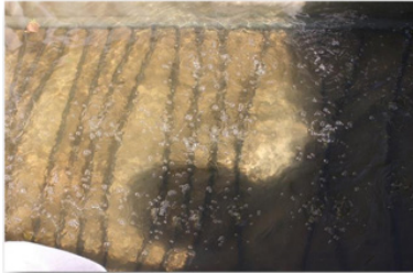
Fotografía 1. Tuberías distribuidoras de aire
